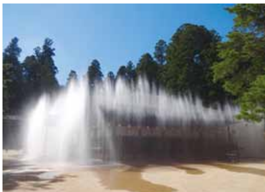
写真6 御影堂のドレンチャー作動風景
