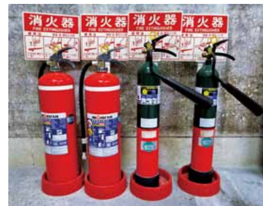
霊宝館収蔵庫にて業務用強化液消火器（左）と二酸化炭素消火器（右）
